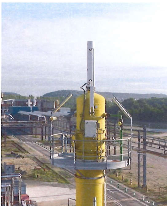
Figure 29 : Photographie de la tête de la colonne D832 – TEGC – Scrubber HCl/Cl 2
